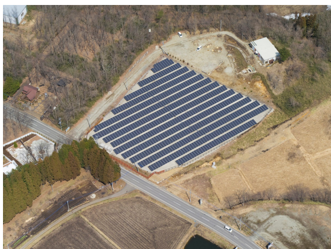
① 栃木県那須郡（発電容量：644キロワット）
