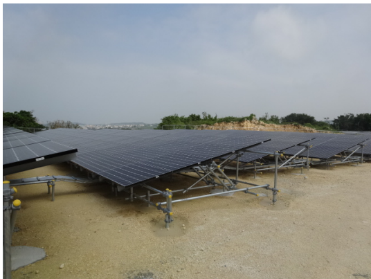
【沖縄県糸満市 太陽光発電所】
